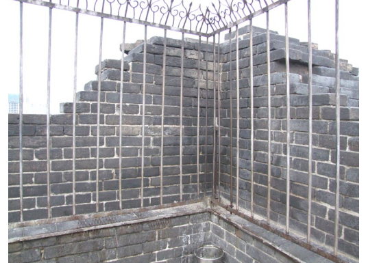
最上階崩れているので鉄柵がある
